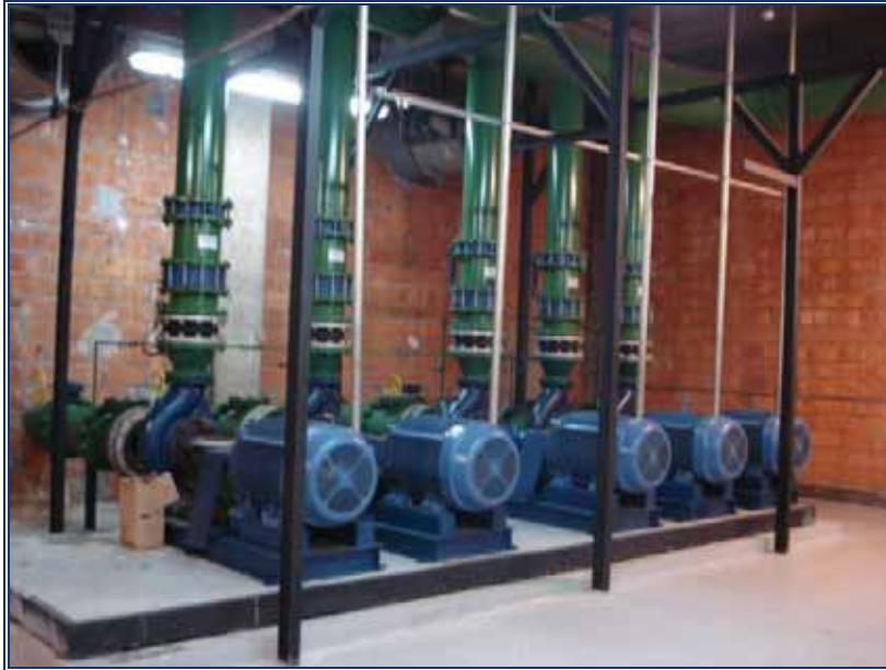
ASPECTOS DAS BOMBAS
