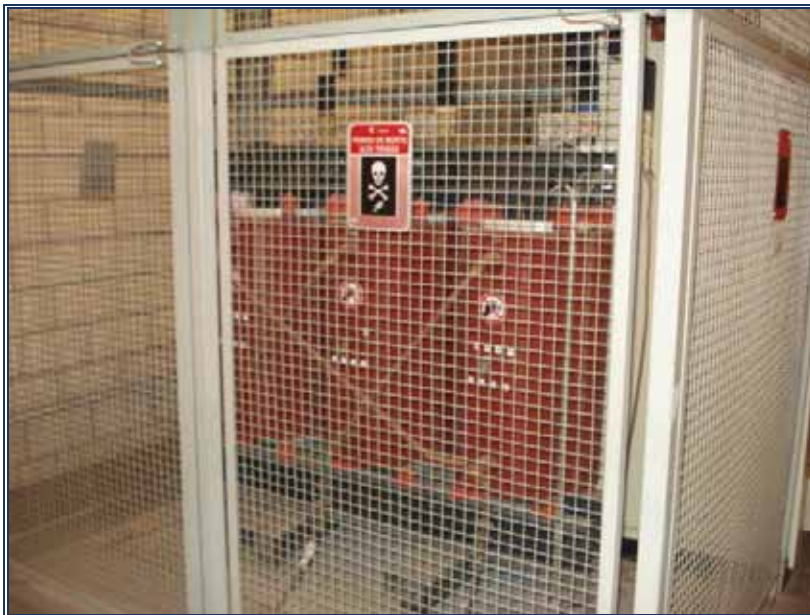
ASPECTOS DA SUBESTAÇÃO
