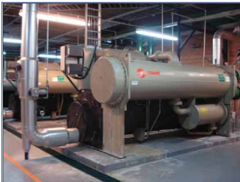
ASPECTOS DO SISTEMA DE AR CONDICIONADO
