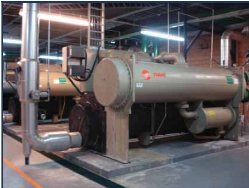
ASPECTOS DO SISTEMA DE AR CONDICIONADO
