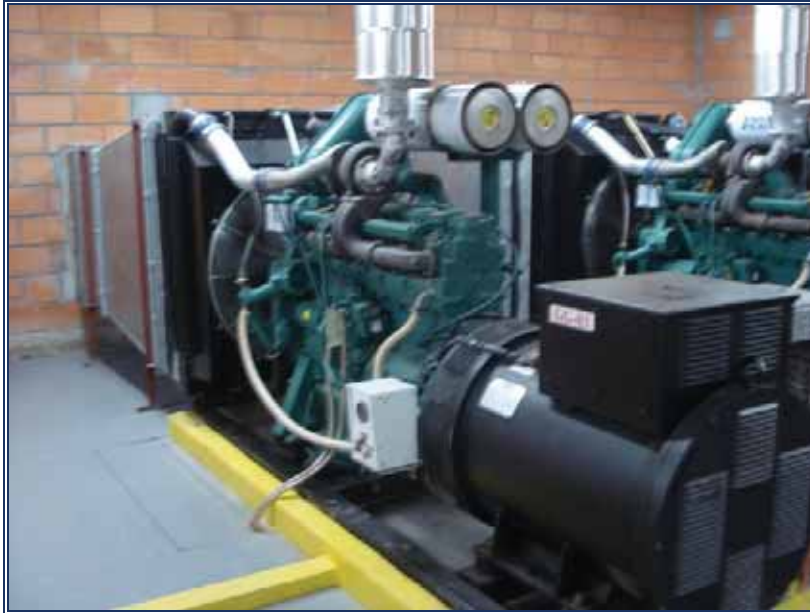
ASPECTOS DOS GERADORES
