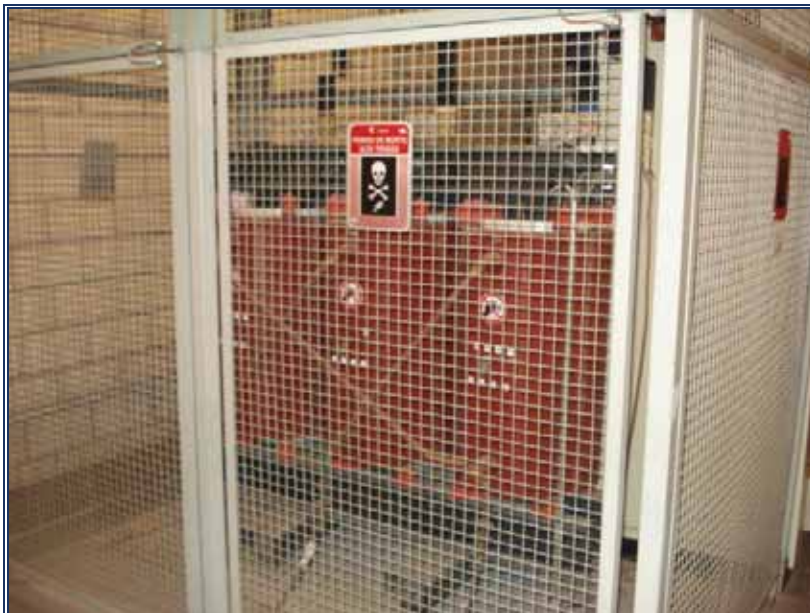
ASPECTOS DA SUBESTAÇÃO
